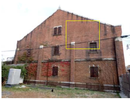
煉瓦の劣化、欠損状況
