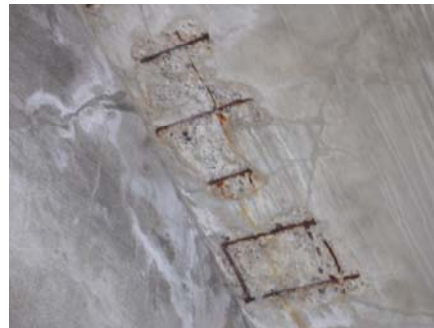
鉄筋腐食(かぶり厚さ不足、ひび割れ)
