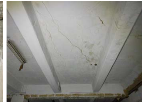
梁方向に延びた多数のひび割れ
