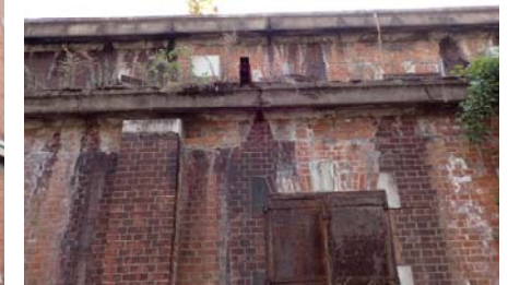
樋の劣化(ひび割れ)による漏水
