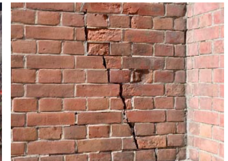
壁端部のき裂状況
