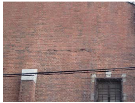
左写真黄色枠拡大:ひび割れ
