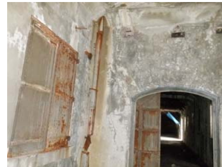
内部モルタルの状況 樋からの漏水跡
