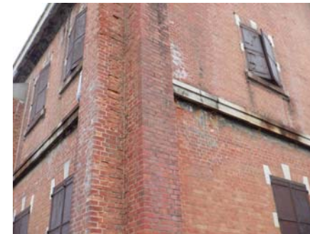
煉瓦の劣化、欠損状況
