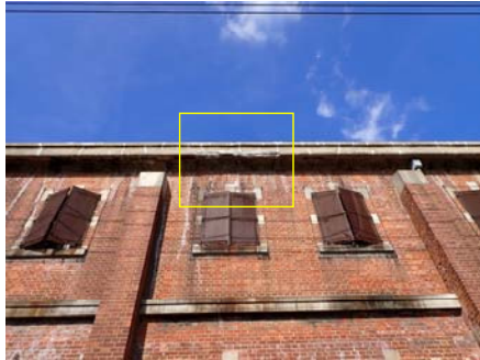
鉄扉の劣化状態と軒の鉄筋腐食
