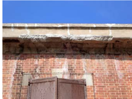
左写真黄色枠拡大:損傷状況
