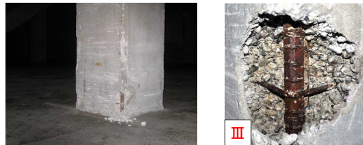
豆板により露出
