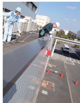
現場にて打診音から凡その異音箇所を判定し、録画データから異音位置を確認します。
