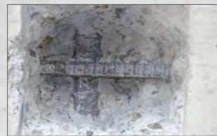
鉄筋の腐食度
