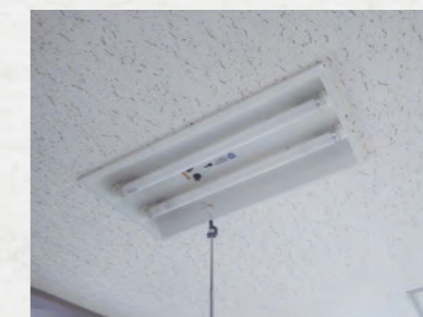
非常用照明点検
