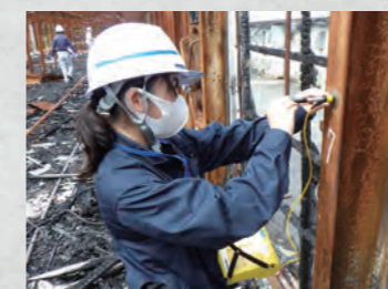
鉄骨造の火害調査
