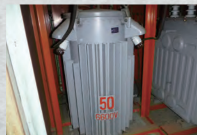
PCB調査(変圧器)
