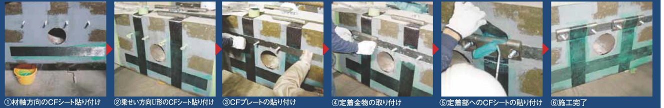
①材軸方向のCFシート貼り付け ②梁せい方向U形のCFシート貼り付け ③CFプレートの貼り付け ④定着金物の取り付け ⑤定着部へのCFシートの貼り付け ⑥施工完了
