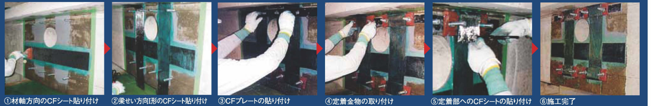
①材軸方向のCFシート貼り付け ②梁せい方向のCFシート貼り付け ③CFプレートの貼り付け ④定着金物の取り付け ⑤定着部へのCFシートの貼り付け ⑥施工完了
