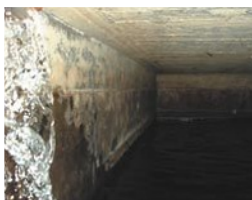
経年劣化の状況
