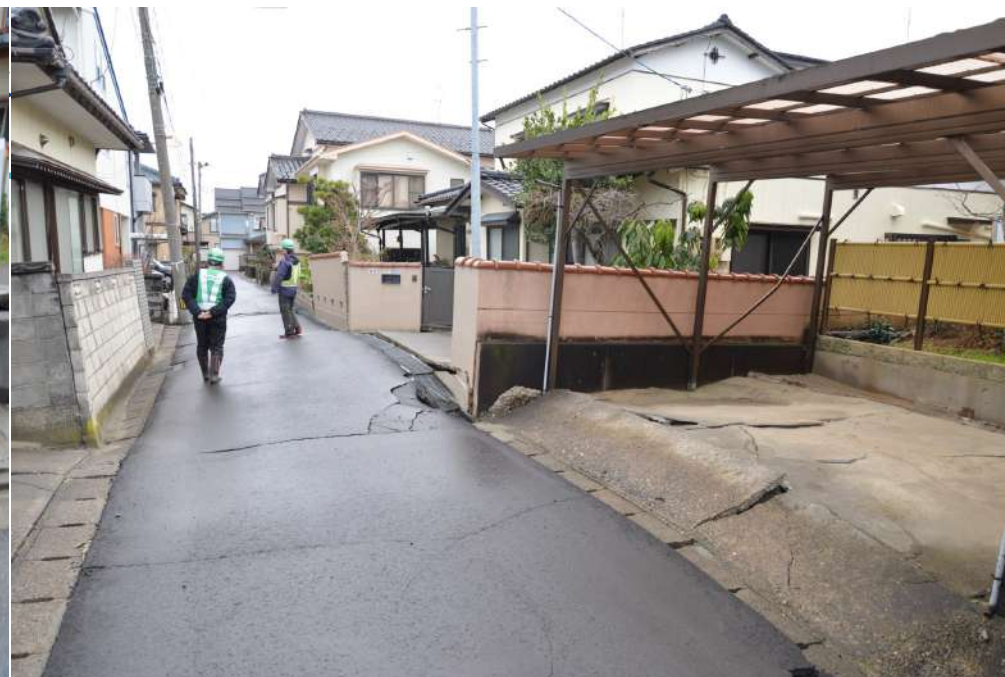
周辺に変位は見られないが、駐車場は隆起して 不同沈下を生じた
