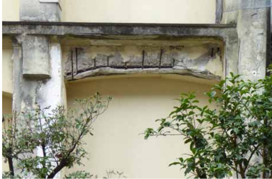
劣化コンクリート
