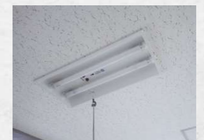
非常用照明点検
