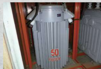
PCB調査(変圧器)
