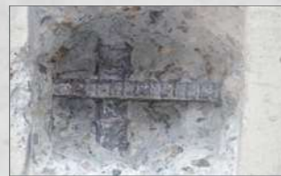
鉄筋の腐食度
