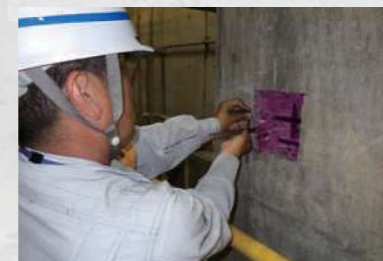
中性化深さ測定
