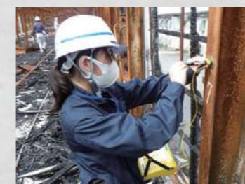
鉄骨造の火害調査
