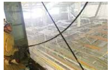
耐震ケーブルブレース
