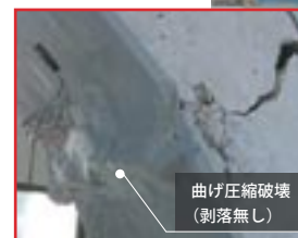
タフネスコート (1.5mm) で被覆した コンクリート覆工 (鉛直変位 \delta=70\text{mm} 時)
