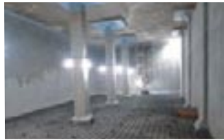
上水用配水池／防火水槽など
