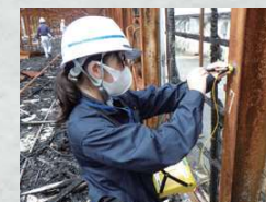
鉄骨造の火害調査
