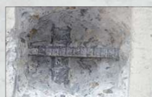
鉄筋の腐食度
