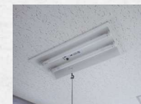
非常用照明点検
