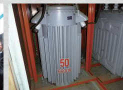
PCB調査(変圧器)
