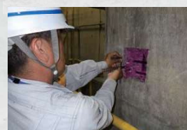
中性化深さ測定
